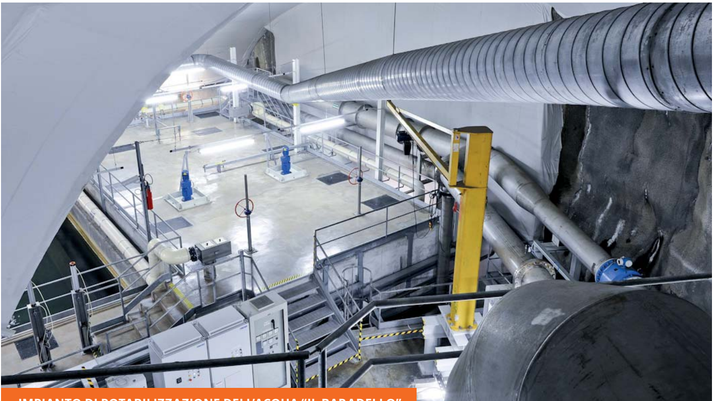
IMPIANTO DI POTABILIZZAZIONE DELL'ACQUA "IL BARADELLO"
